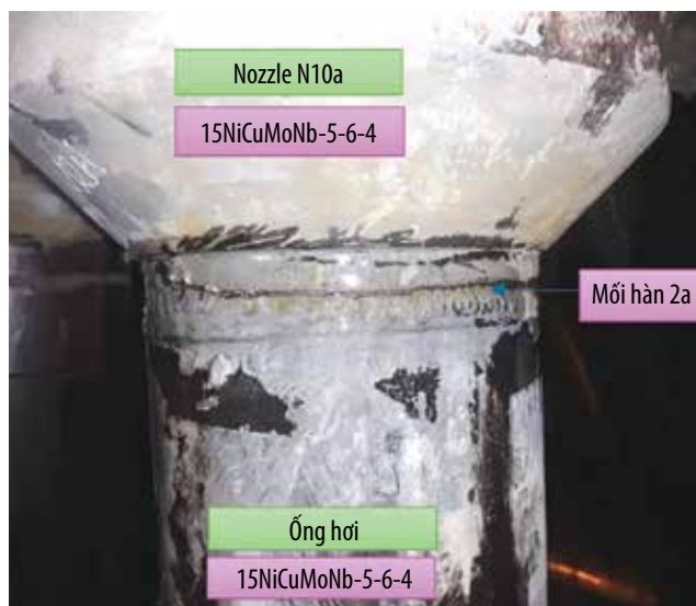
Hình 3. Nứt tại chân mối hàn.
